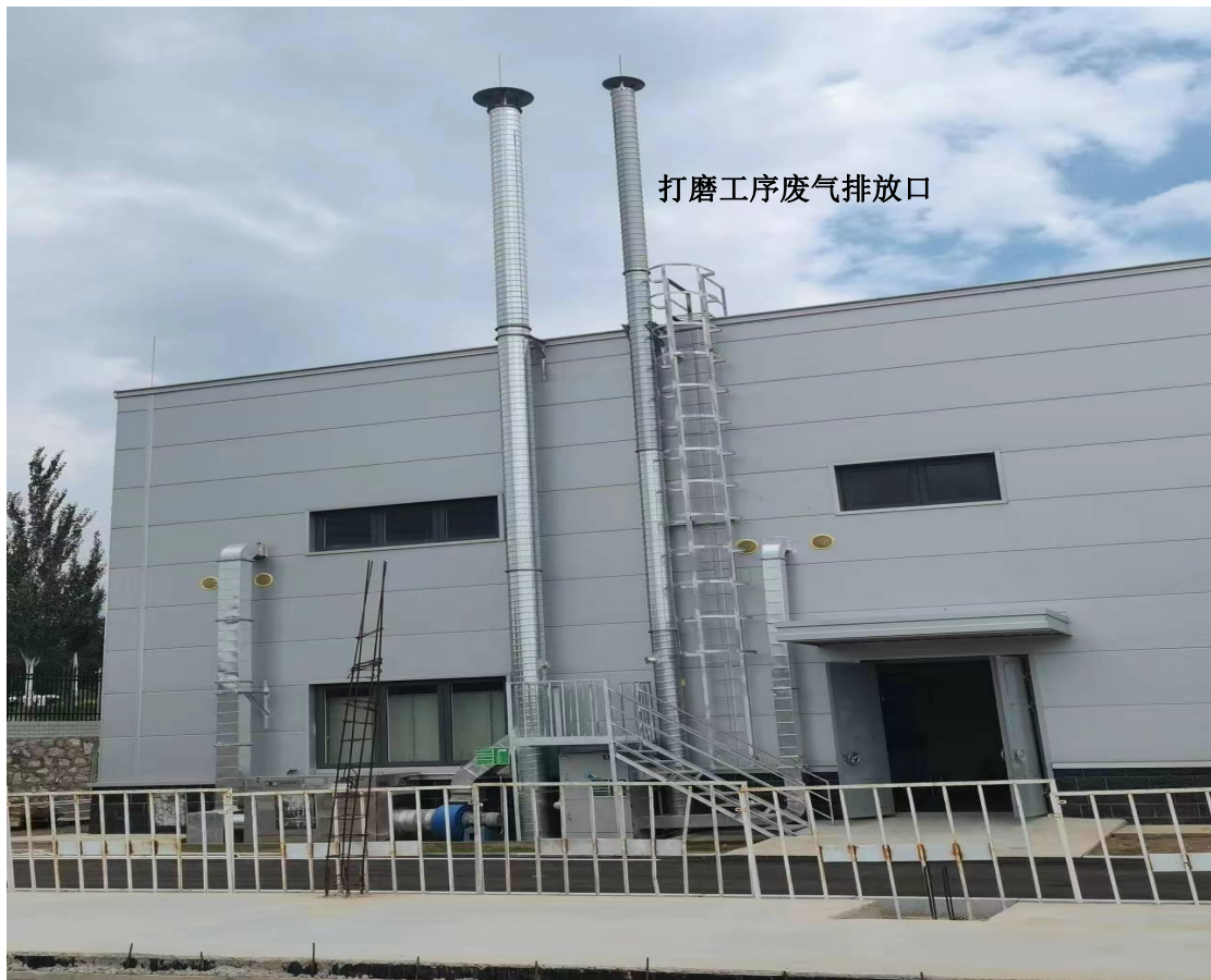
打磨工序排气筒照片（右 1）
