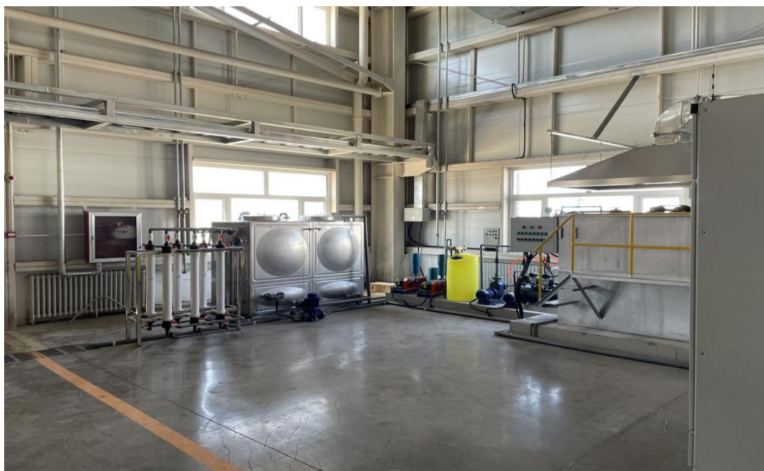
污水处理设施 1
