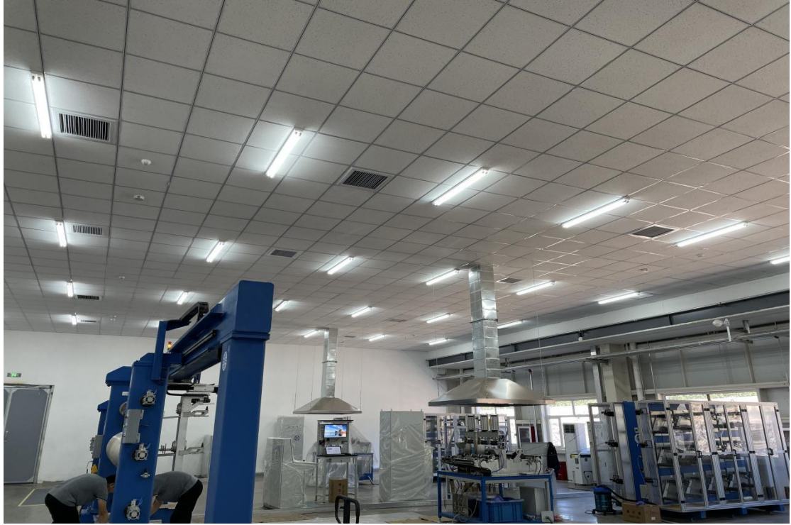
现场集气罩照片
